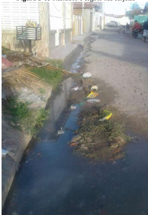
Figura 3-69 Resíduos e esgoto nas sarjetas
