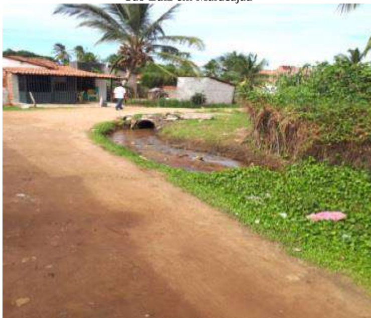
Figura 3-61 - Córrego seguido de Passagem molhada no conjunto São Luiz em Maracajaú
