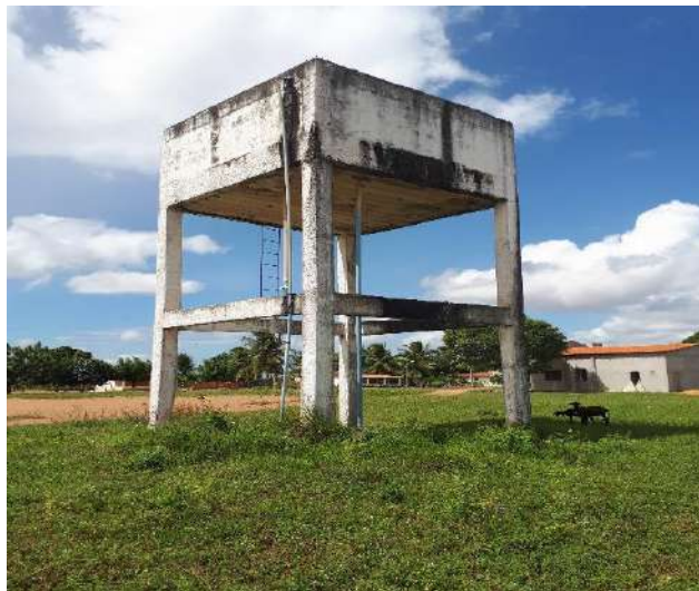
Figura 3-29 Reservatório presente na Comunidade Vila Verde
