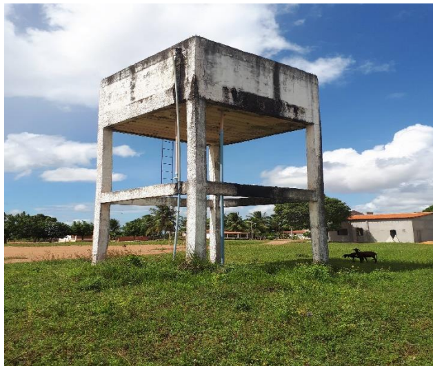
Figura 3-29 Reservatório presente na Comunidade Vila Verde
