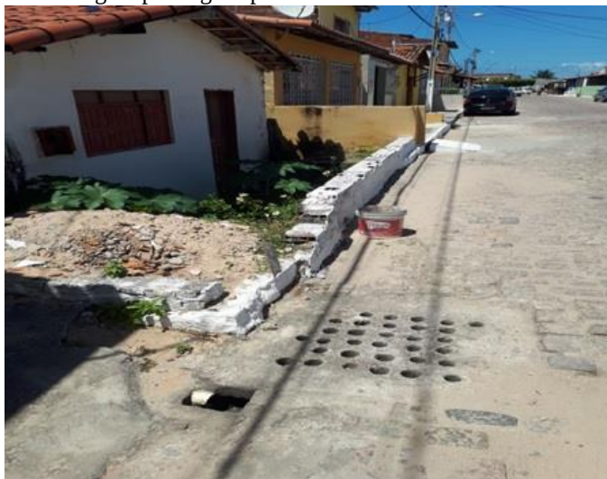
Figura 3-57 - Ligação clandestina de esgotos na rede de drenagem para águas pluviais na rua Alexandre Câmara
