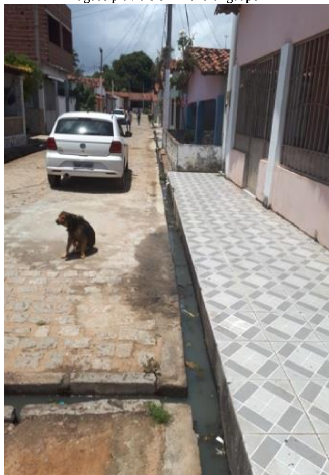
Figura 3-58 - Presença de esgotos na rede de drenagem para águas pluviais em Maxaranguape
