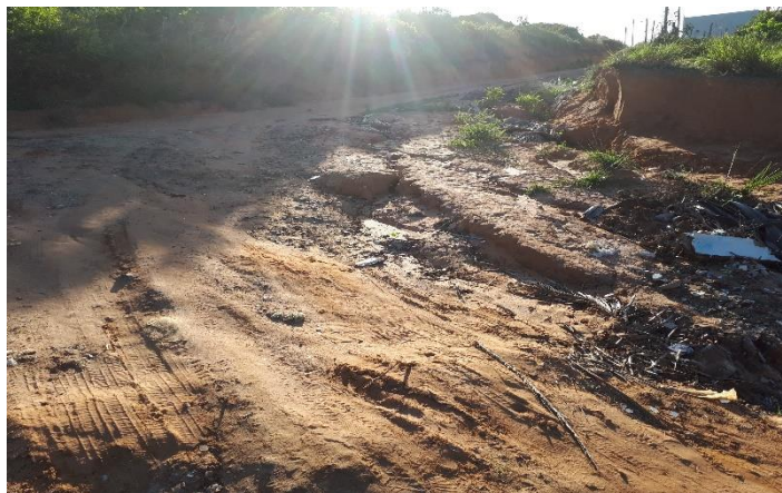
Figura 3-64 Ravinas e carreamento de lixo na área de encostas do rio Maxaranguape.
